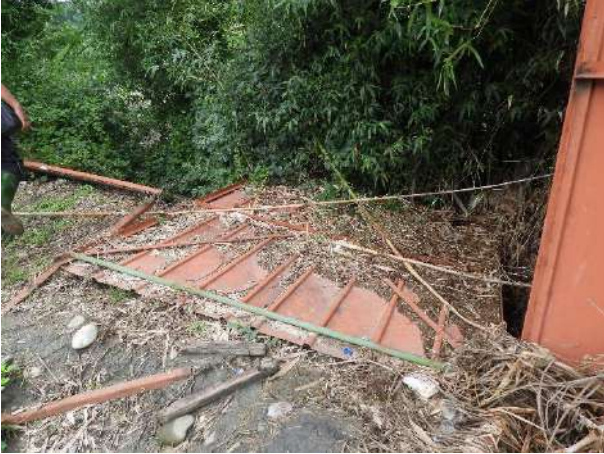
3P36 旁圍籬受損
