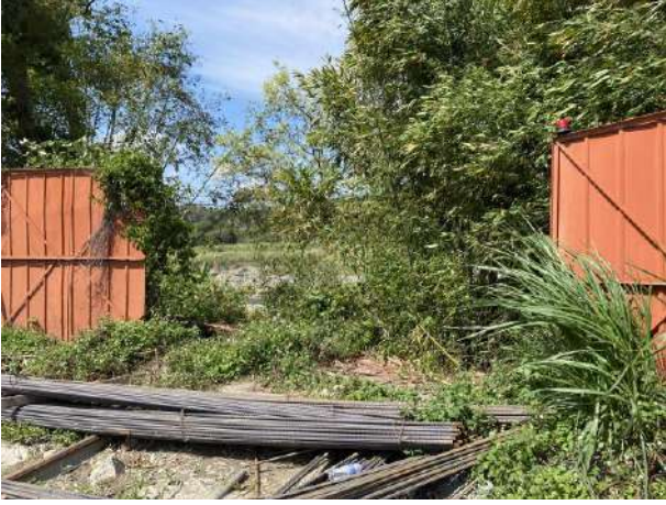
圍籬倒塌形成缺口
