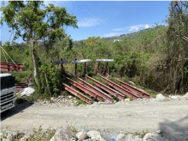
物料暫置區未設置阻隔設施
