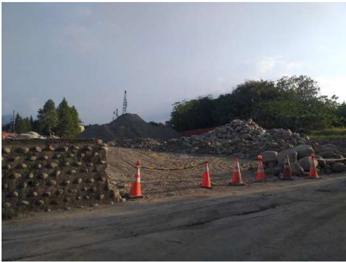
4. 現勘時無發現揚塵，但仍建議設置防塵網於裸露土方上，或定時灑水於工程機具與大車行駛的道路上。
